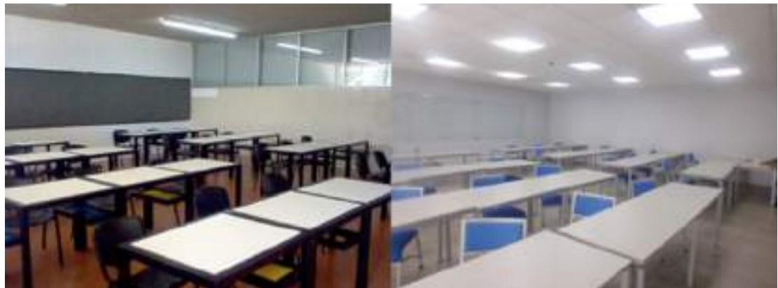
Figura 9. (Izq.) Aula antes de la remodelación. (Der.) Vista de aula posterior derecho, el aula cuenta con iluminación led y mobiliario adecuado para las actividades prácticas que requiere la academia (Coordinación de Servicios Generales).
